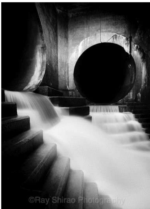
東京都足立区の梅田幹線(左)と西新井幹線(右)の合流部。1984(昭和59)年完成。三脚を使った長時間露光で、水の流れる姿を滑らかに写し出す。階段状の流路は美しく美しい。 ©Ray Shirao Photography
