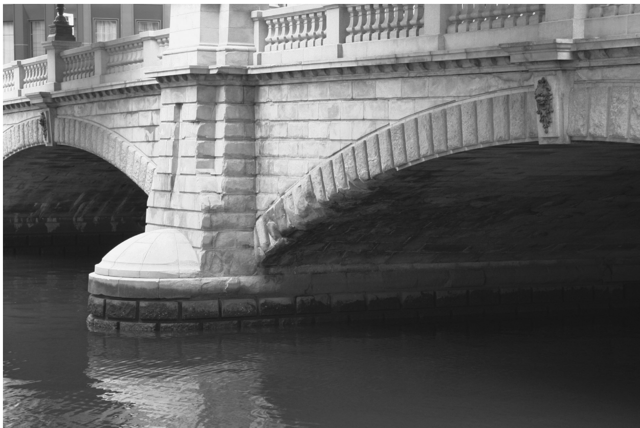
写真1 日本橋の震災時の傷跡（上流側）
