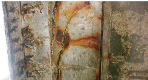
図-1 床版下面のひび割れ
