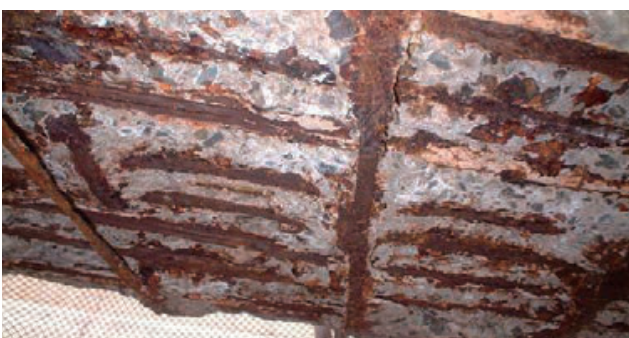
図-3 大規模な剥落と鉄筋露出
