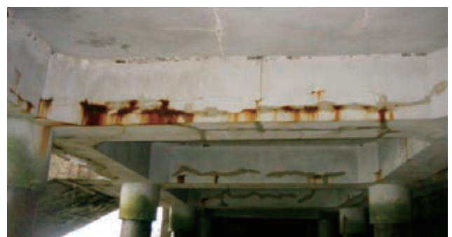
図-4 補修後の再劣化
