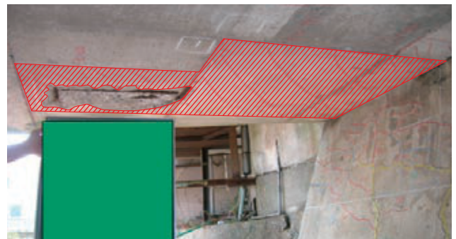
図-2 コンクリートの浮き、剥離
