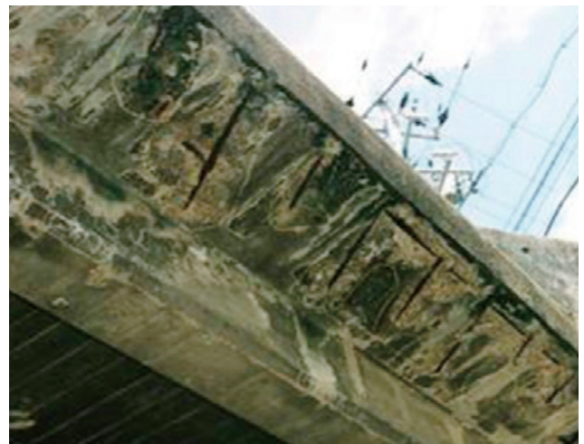
図-2 張出し床版下面の鉄筋露出
